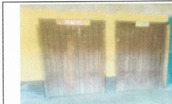
Foto 4: Puertas de madera deterioradas sin mayor seguridad para el resguardo de bienes.
