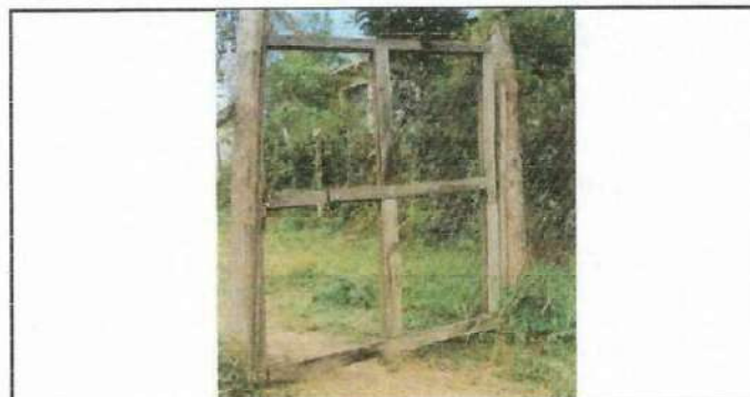
Foto 12: Portón de ingreso que se necesita sustruir
