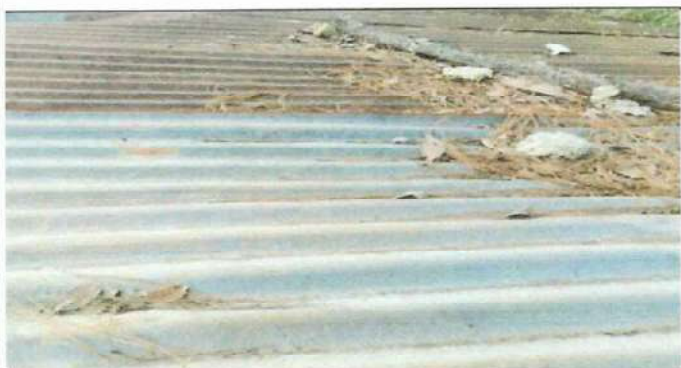
Foto 9: Láminas que requieren sustrucción por su deterioro por oxidación.
