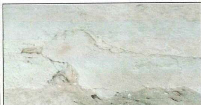
Foto 3: Foto 2: Piso deteriorado que necesita sustituirse.
