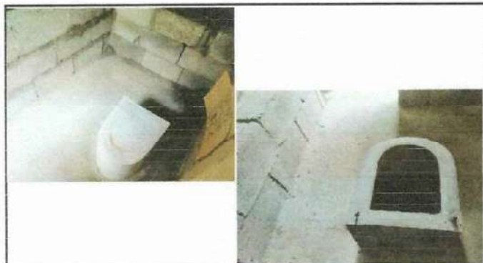
Foto 10: Inodoros que requieren sustrucción.
