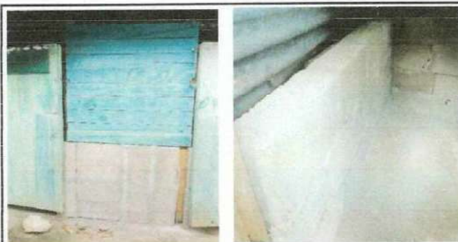
Foto 11: Paredes de servicio sanitario que se requieren sustruir
