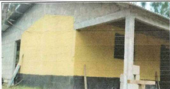
Foto 1: Paredes del interior y exterior de todo el edificio se encuentra sin cernido y además requiere de pintura.
